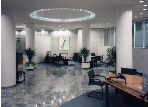
Einsatz einer CLIMATT-GK Kühldecke mit Akustikputz in dem Bankhaus Neelmeyer in Bremen
