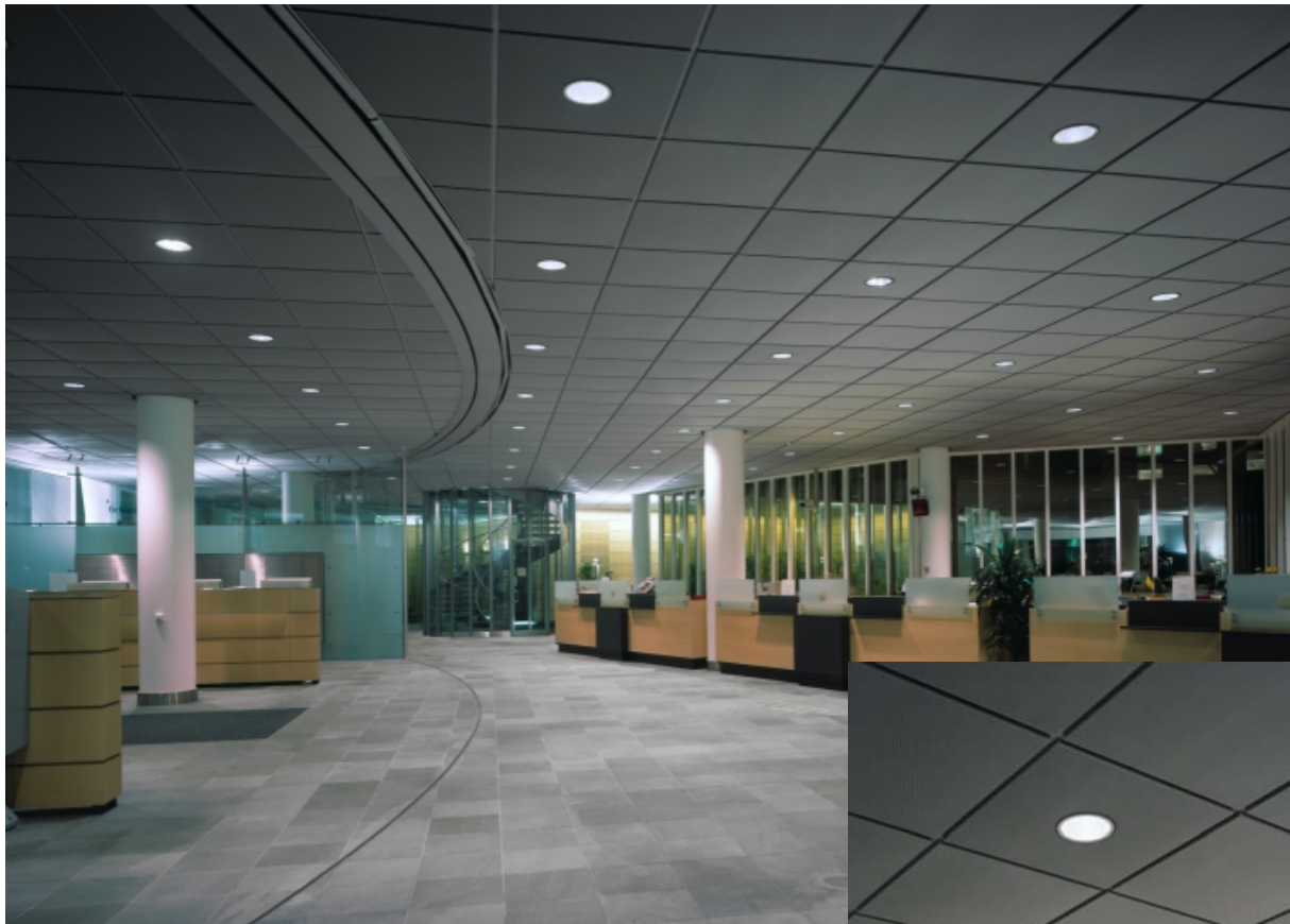
CLIMATT-Streckmetallkühldecke in der Commerzbank Bremen
